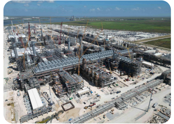
GOLDEN PASS LNG IN TEXAS
